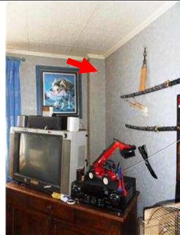
031 - Appartements - Chambre LOT 0102 PH26 : amiante ciment
